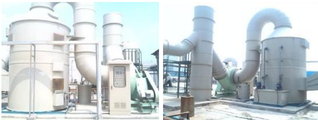
图 3-3 蚀刻线废气处理系统改善设备实景图
