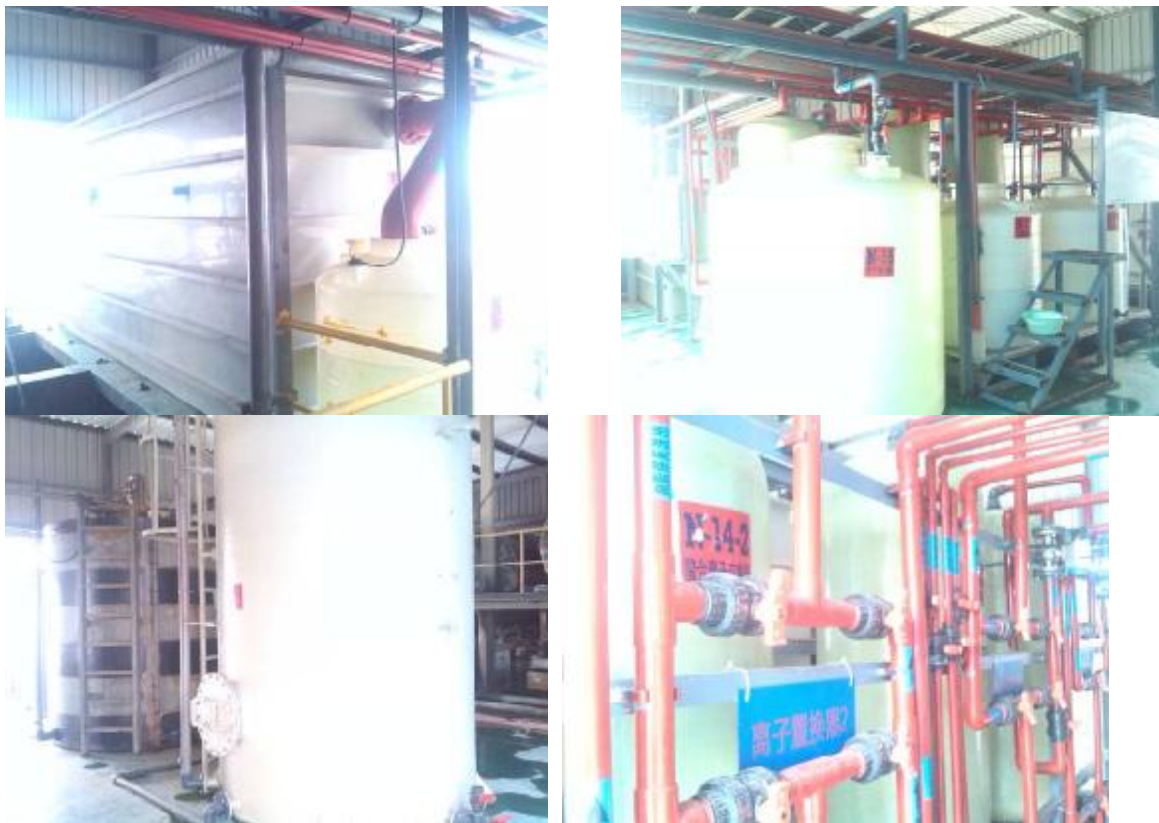
图 3-9 公司污水处理站改造设备实景图
