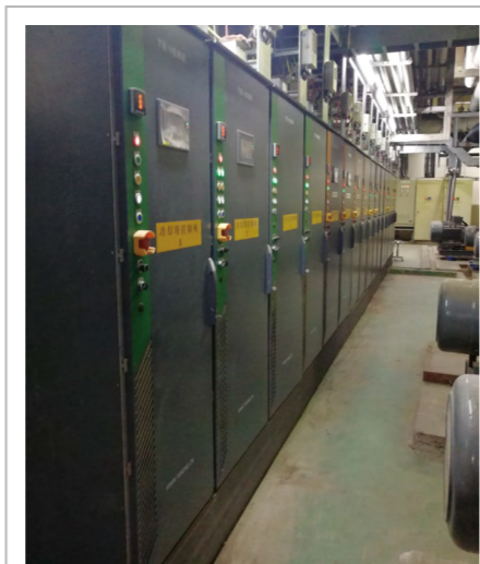
▲ 利用變頻器調節冷卻泵二次泵使冰水機達到節能效果
