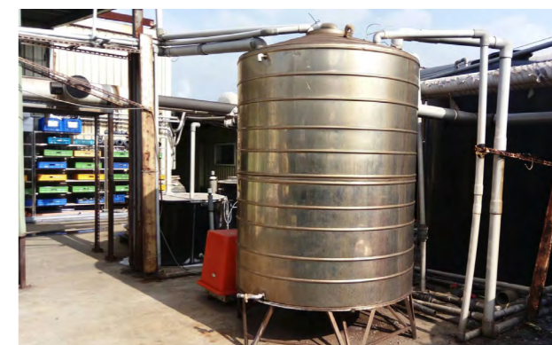
純水設備於反洗過程中會產生一定比例的廢水，此廢水水質仍良好，透過中央桶槽收集後，可運用於：(1) 空調散熱水塔；(2) 空污洗滌塔；(3) 廁所馬桶的使用。
