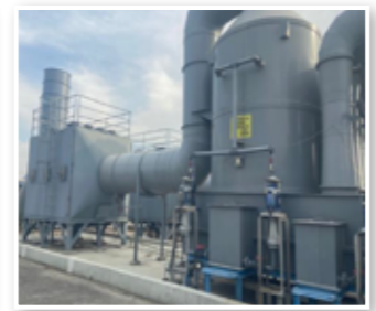
新增有機廢氣處理塔
