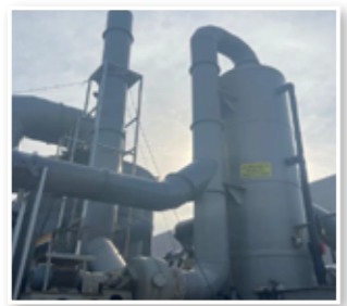
新增氟化物廢氣處理塔
